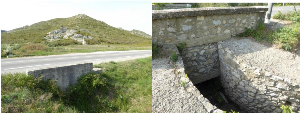
Photos des traversées de la RD 569 des cours d'eau
